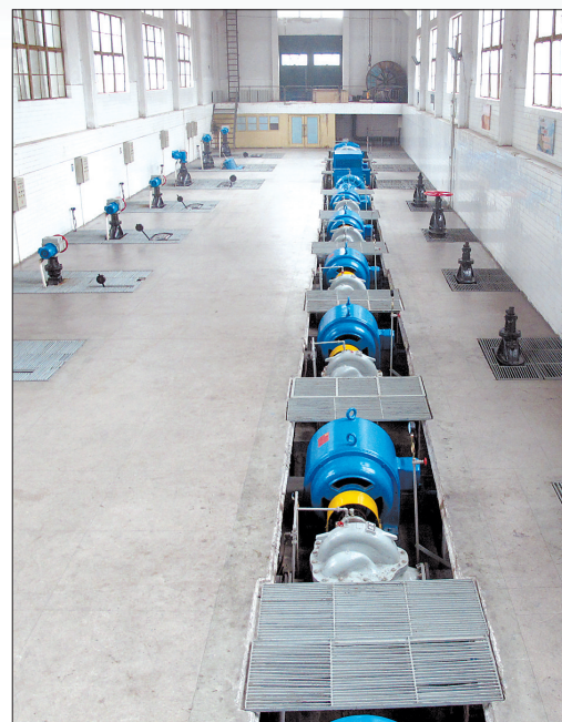
经过泵将净化好的自来水输入城市供水管道
