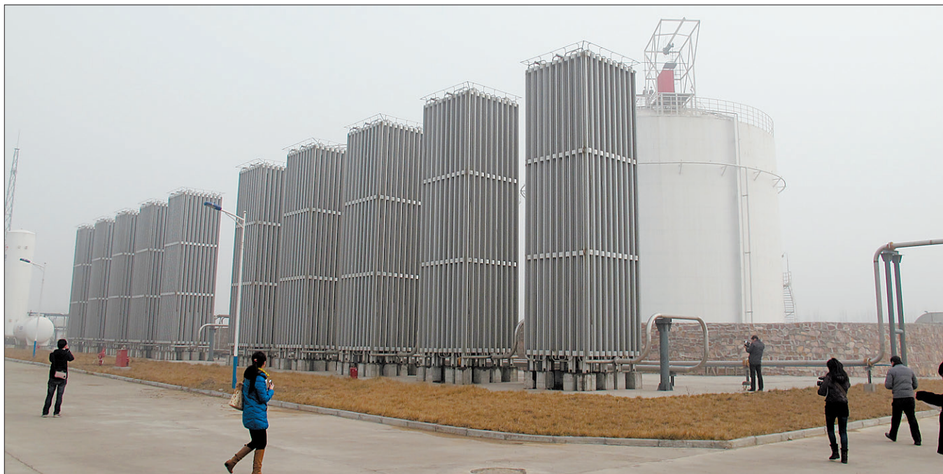
汝阳县顺和能源有限公司的气化器和储罐
