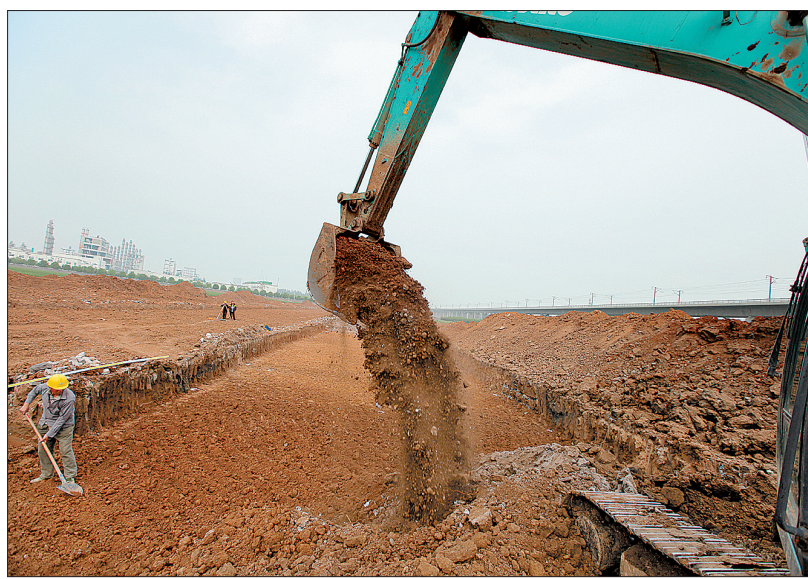
正在加紧施工的洛龙高新技术产业开发区道路——关林大道西延线 苟华云 摄
