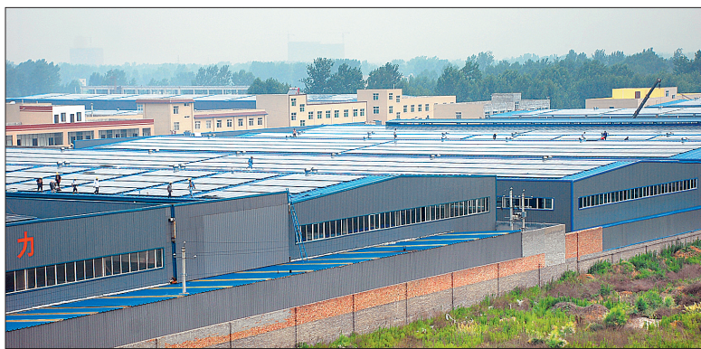
昨日,耀强车桥科技有限公司生产车间屋顶正在安装太阳能电池板
