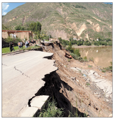
岷县被震垮的公路
