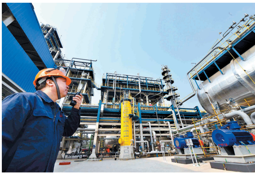
洛阳石化的工作人员在检查设备运行情况 记者 潘郁 摄
