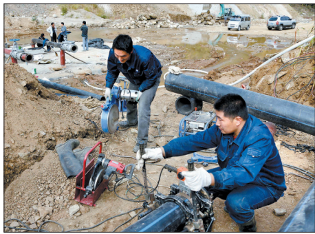
在栾川县栾川乡后坪村伊河流域修建的渗水井,每天可向县城供水4500立方米
