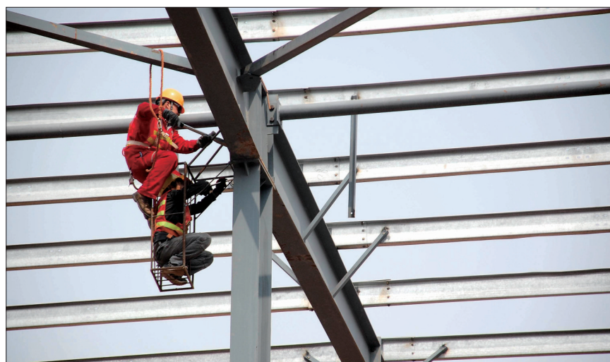
近日,在国机重工(洛阳)产业园项目工地上,建设者正在进行厂房施工 记者 潘郁 摄
