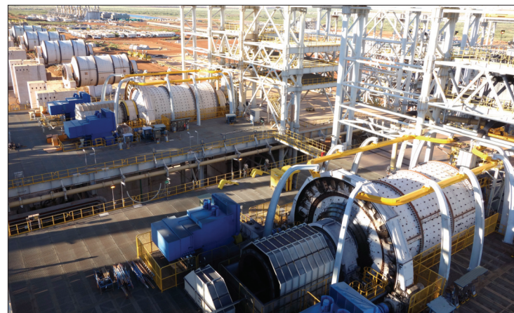
中信重工提供核心装备的海外铁矿山生产线
