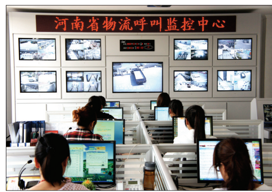
省物流呼叫监控中心实景
