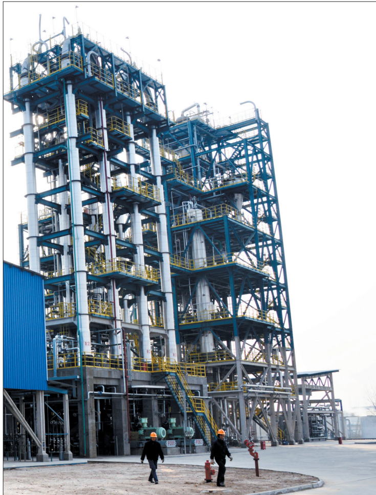
洛阳石化产业集聚区洛阳石化年产14万吨聚丙烯项目 记者 鲁博 摄
