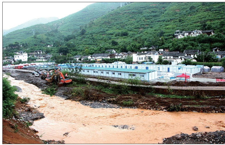
8月11日,在鲁甸县龙头山镇龙泉村葫芦桥社一处开闢农田,地震灾区第一所板房医院搭建完毕 (新华社发)
