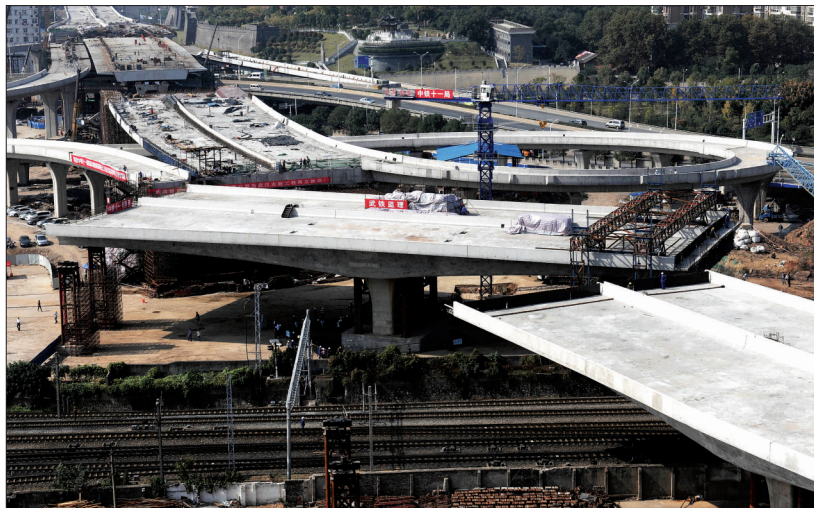
10月24日,武汉鹦鹉洲长江大桥跨京广铁路段进行转体施工(新华社发)
