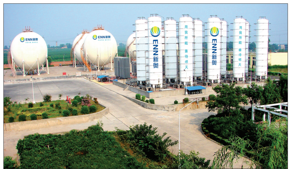
位于邙山的液化天然气储罐群
