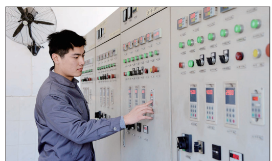
操作污泥脱水系统
