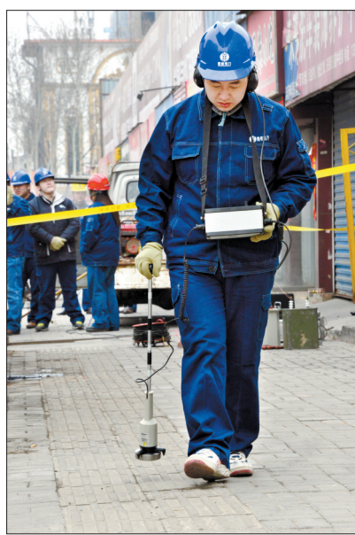
用定点仪“透视”狭小缆沟内的故障
