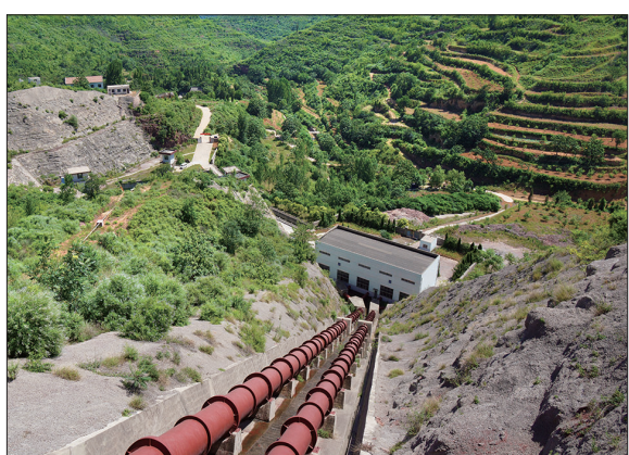
小浪底南岸引水工程孟西灌区乔庄提水系统
