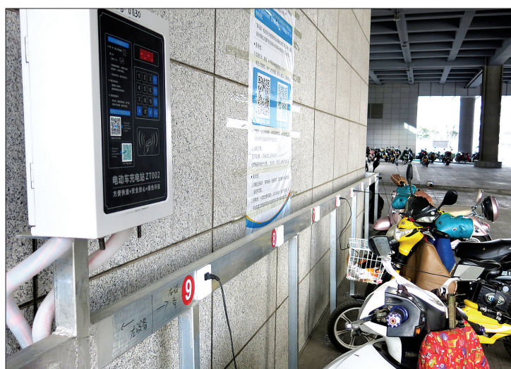
安装在洛阳会展中心的电动车充电站
