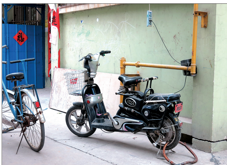
洛龙区某居民小区电动车“飞线”充电
