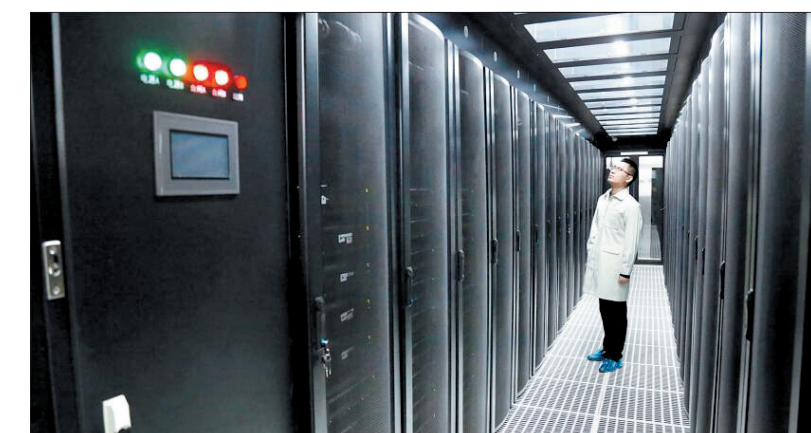
在位于洛阳大数据产业园内的河南移动中原大数据云计算中心机房里,海量数据被储存和运算。(资料图片)
