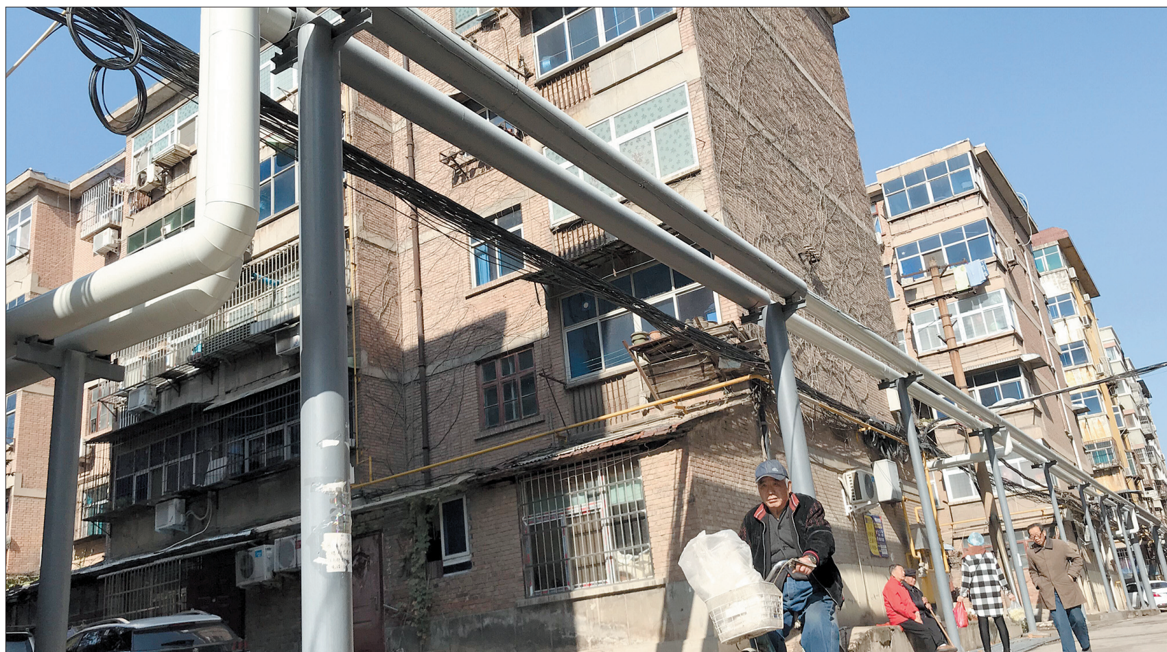
老旧小区室外安装的供热管网
