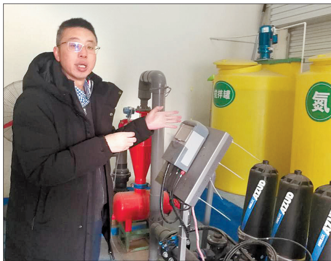
水肥一体化系统
