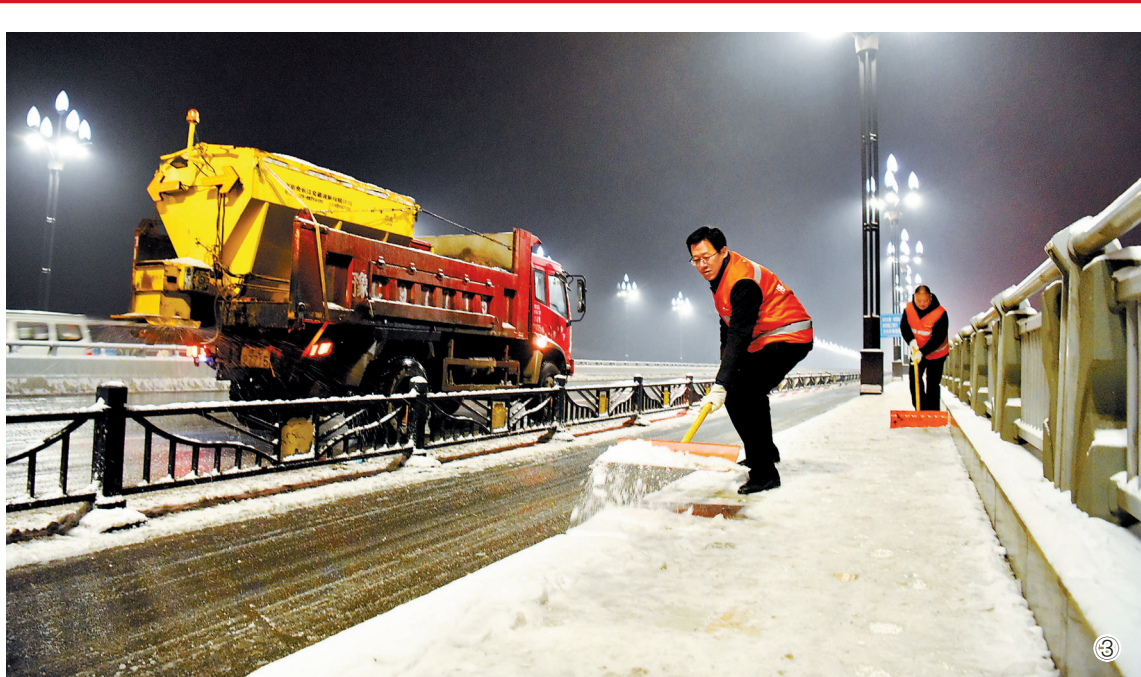
13日,我市普降小到中雪。为应对降雪天气,我市多部门采取措施加强应对,对市区道路、桥梁、陡坡及机场、铁道等进行撒融雪剂除雪作业和人工扫雪,保障群众出行安全。
