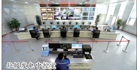
垃圾发电中控室
