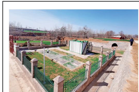
新建成投用的村级一体化污水处理站
