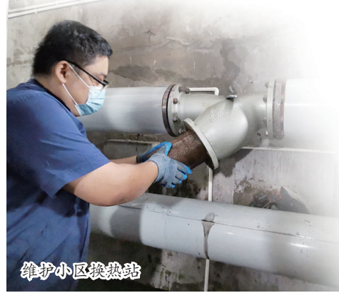
维护小区换热站
