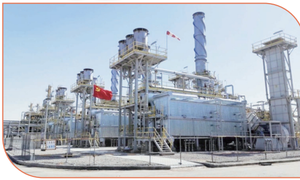
哈法亚油田天然气处理厂项目
