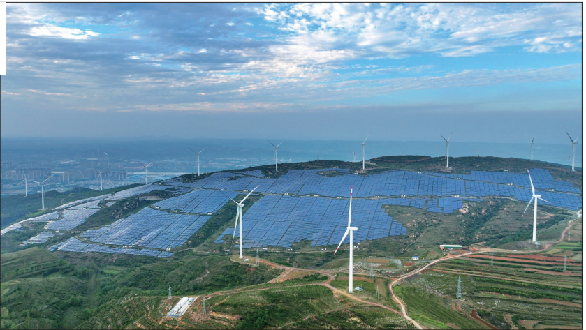
宜阳县樊村镇境内山体上的风力、光伏发电站 洛报融媒记者 梅占国 摄
