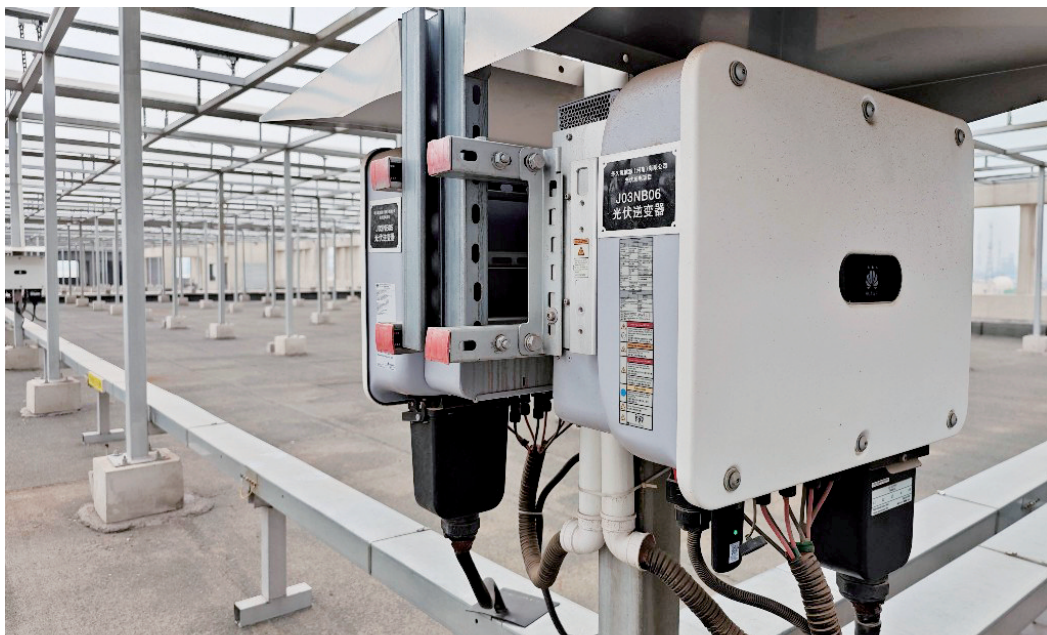
光伏电站项目现场
