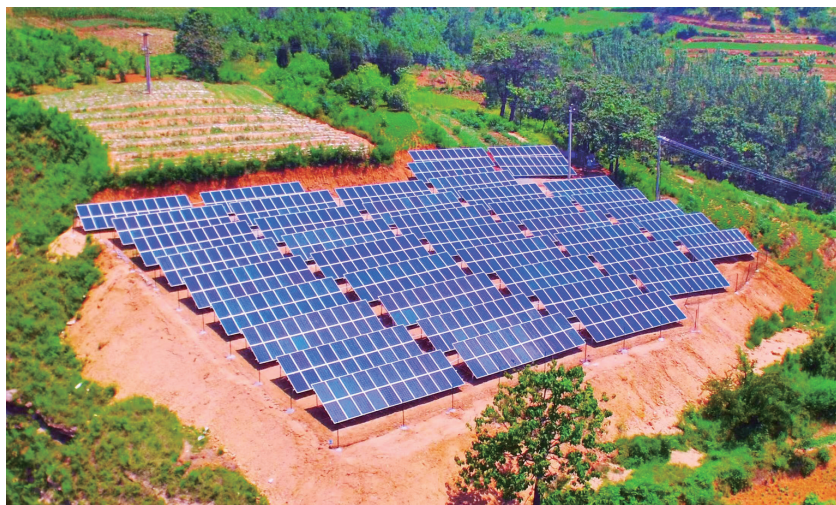
嵩县沟村光伏发电站
