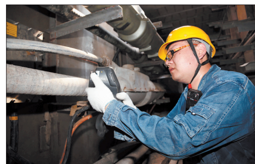
工作人员在检查线路
