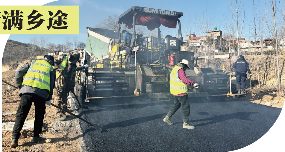
道路是鸦岭镇推进“东进北融抢抓机遇、富硒农业促发展”战略实施的关键一环,也是沿线殷沟、王庄、曹窑等村广大群众期盼已久的民心工程。过去因为资金、拆迁、用地等因素制约,镇、村谋划多次,都没能成功实施;今年镇、村召开多次协调会,解决了资金缺口、项目用地、线路优化等问题,最终形成建设方案,计划明年元旦前建成通车。 张睿祥 文/图
